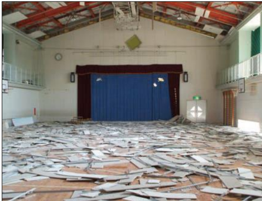
屋内運動場の天井材の脱落
