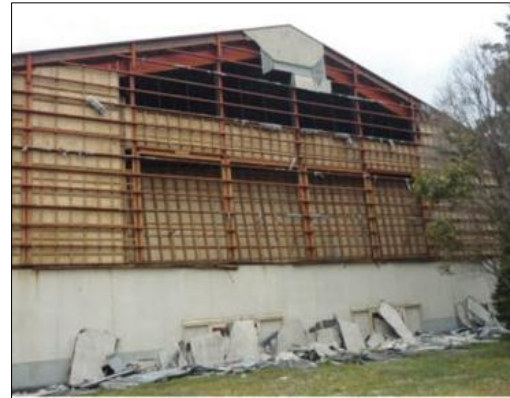
外装材の脱落
