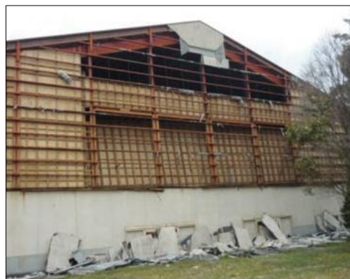
外装材の脱落
