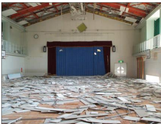
屋内運動場の天井材の脱落
