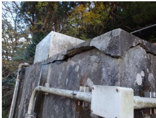
図 4-1 配水池老朽化状況
