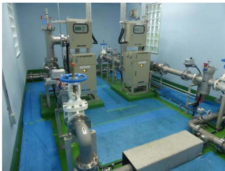
図 7-1 大平台第2配水池に設置した紫外線処理装置
